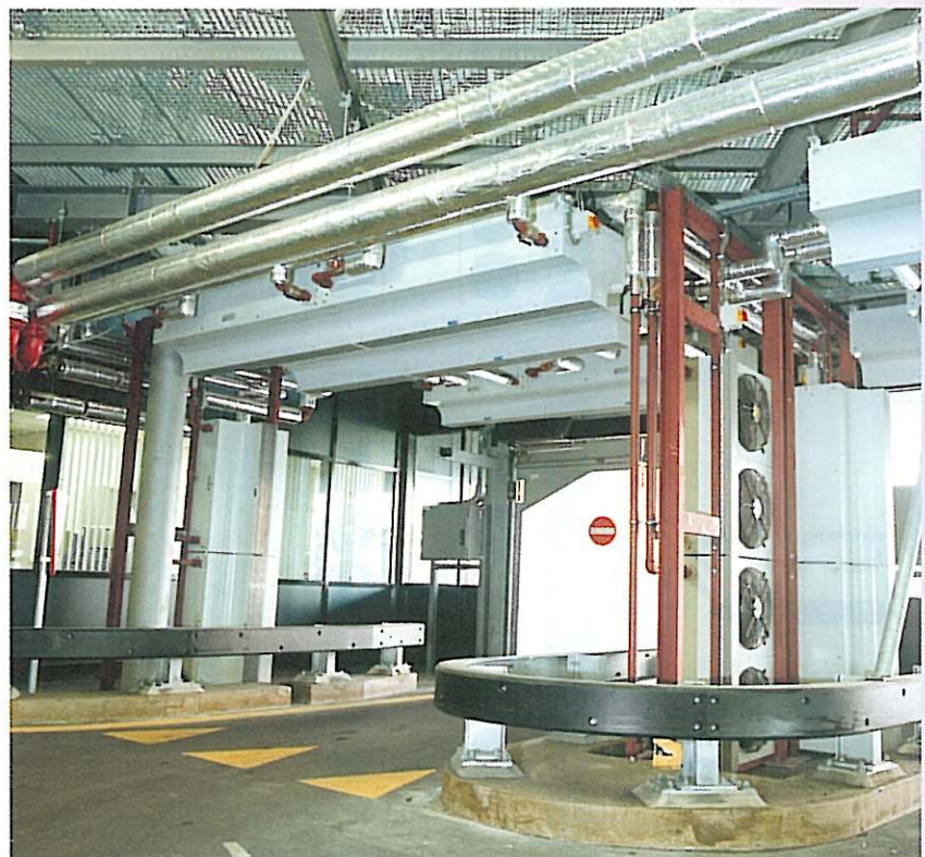
Rondom de deuropening zijn tien industrie-luchtgordijnen gemonteerd [Bron: Schiphol Group]
