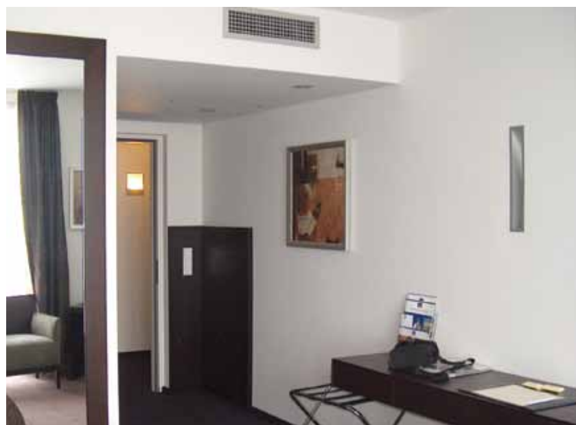
Hotelkamer in Nobis; de projectventilatorconvector, model SL, is ingebouwd in het plafond (koof).
