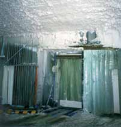
Door ijsafzetting en mist ontstaan gevaarlijke situaties.
