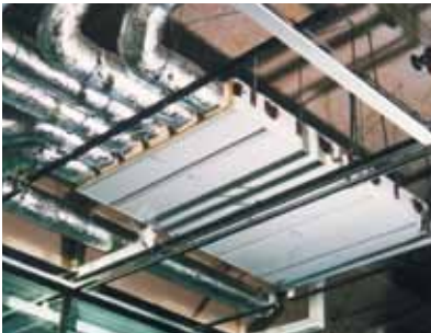
PS in abgehängter Decke montiert
