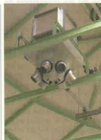
Eine saubere Sache: Die Filter des Luftherhitzers müssen nur zweimal im Jahr gewechselt werden
