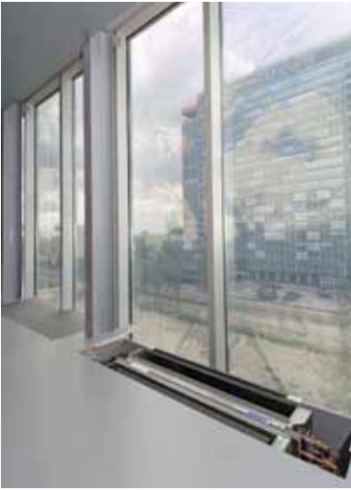
Gebläsekonvektor SL an der Fassade der Technischen Universität Delft (NL).
