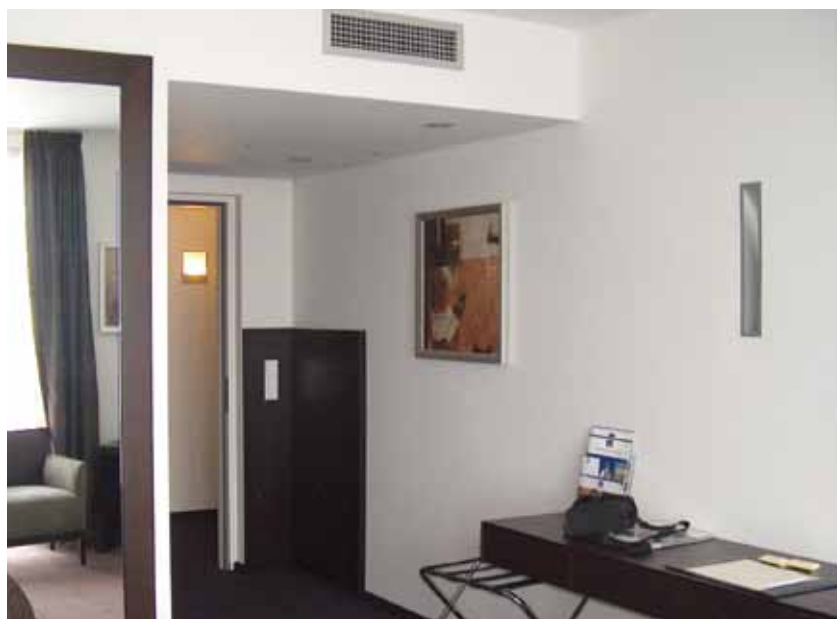
Zimmer im Nobis-Hotel in Asten (NL): Gebläsekonvektor SL als Deckeneinbaugerät (abgekoffert)
