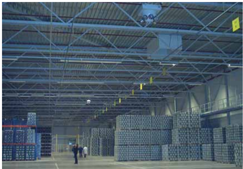
In de opslaghallen van de Grolsch brouwerij in Enschede zijn Biddle luchtverwarmers toegepast.
